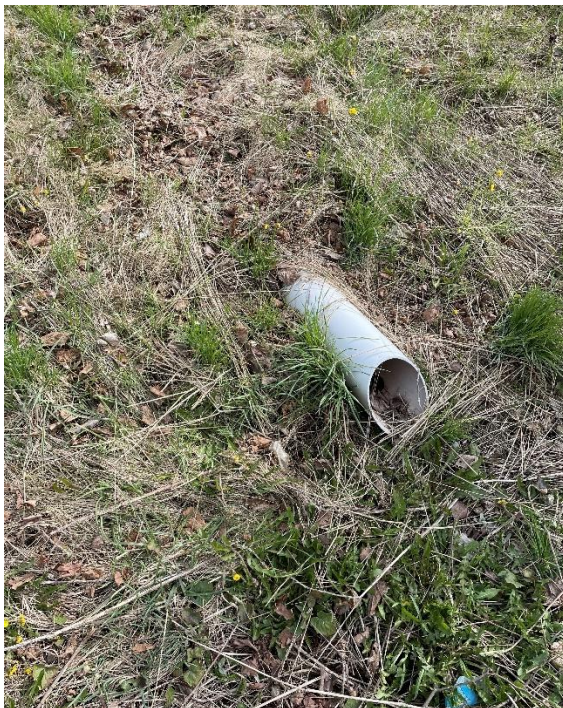
Figur 7. En mindre utloppsledning som påträffats vid dammens lågpunkt. Utloppet misstänks avvattna en närliggande kupolbrunn, men det har ej kunnat verifieras. (Bildkälla: Tyréns)
