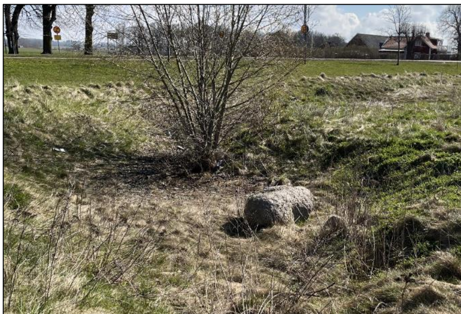
Figur 3. Vy mot Skänningevägen. Foto på den del av fördröjningsdammen som ej har fyllts igen. I dammen finns fortfarande en mindre brunn och ev. dräneringsledning (oklart om den är i drift). (Bildkälla: Tyréns)
